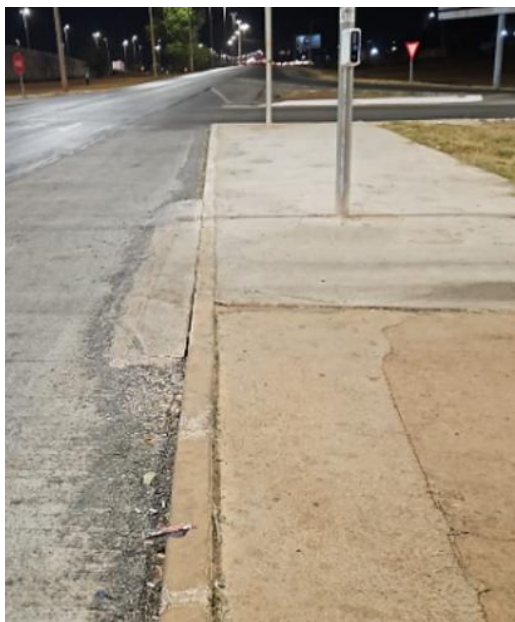
Figura 17 - Rampa atingindo a pista de rolamento.
