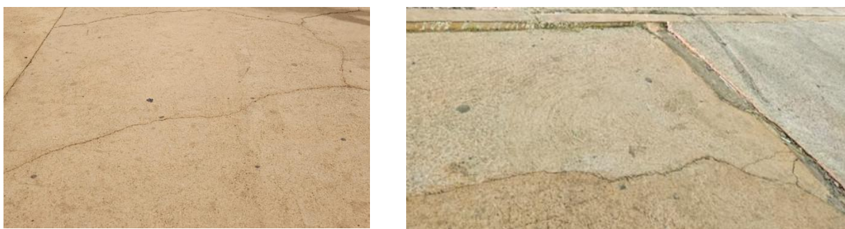
Figura 6 - Fotos da calçada danificada, localizada perto do abrigo de passageiros para embarque sentido Planaltina.
