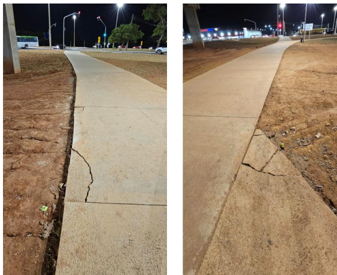
Figura 5 - Fotos de passeios danificados.
