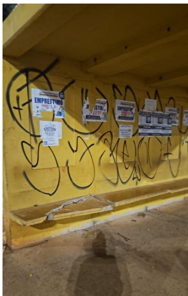
Figura 19 - Assento danificado do abrigo de passageiros.
