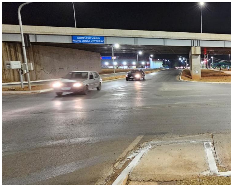
Figura 12 - Marcação de área de pavimento não utilizável quase ilegível.
