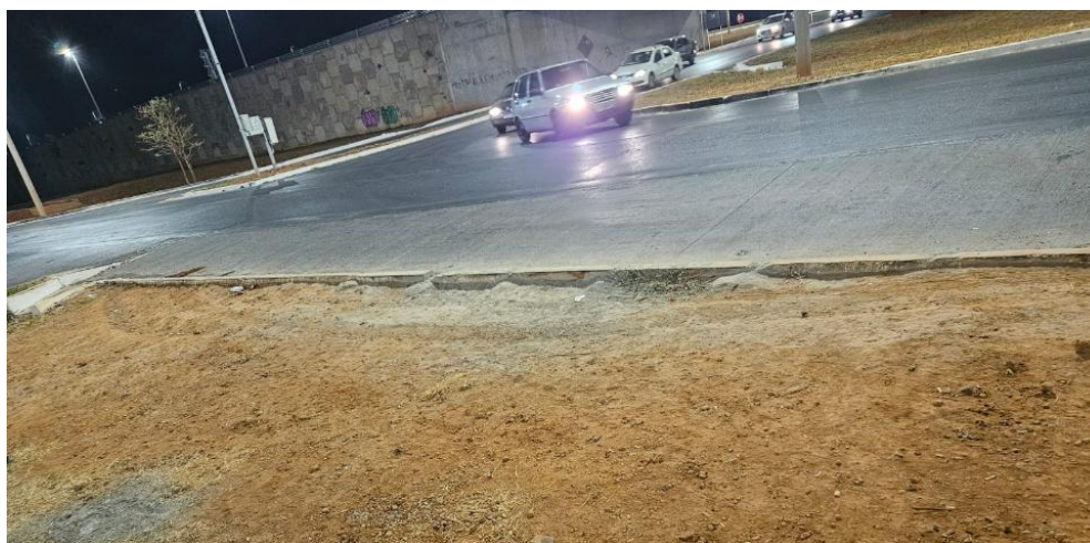
Figura 20 - Área após o meio fio com marcas de pneu de ônibus.
